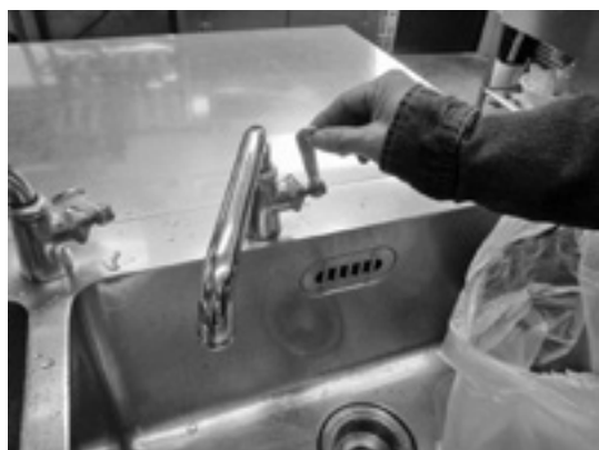
第 15 回市営保育所水廻り点検（ひかり保育所） 調理室 レバーハンドル不良
