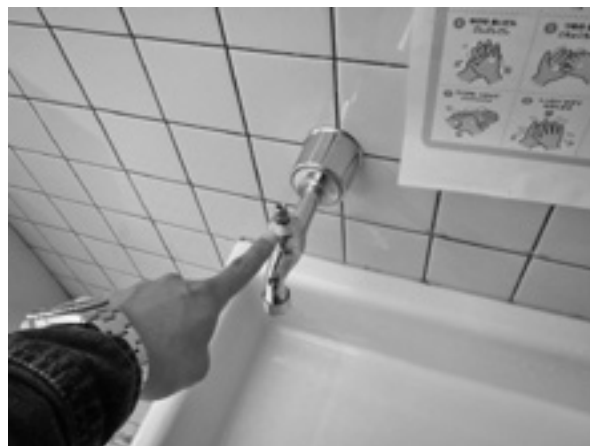
第 14 回市営保育所水廻り点検 (弓削保育所) トイレ 手洗器三角ハンドル無し
