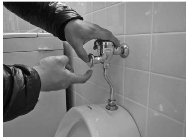
2 階幼児用便所 小便器フラッシュ 押しボタン部漏水
