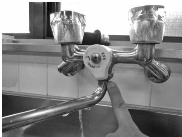
幼児棟 調理室 2 バルブ混合水栓 吐水管漏水
