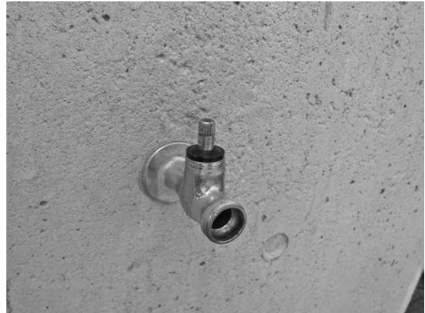
水栓上部からの漏水があり パッキン取替を行いました。
